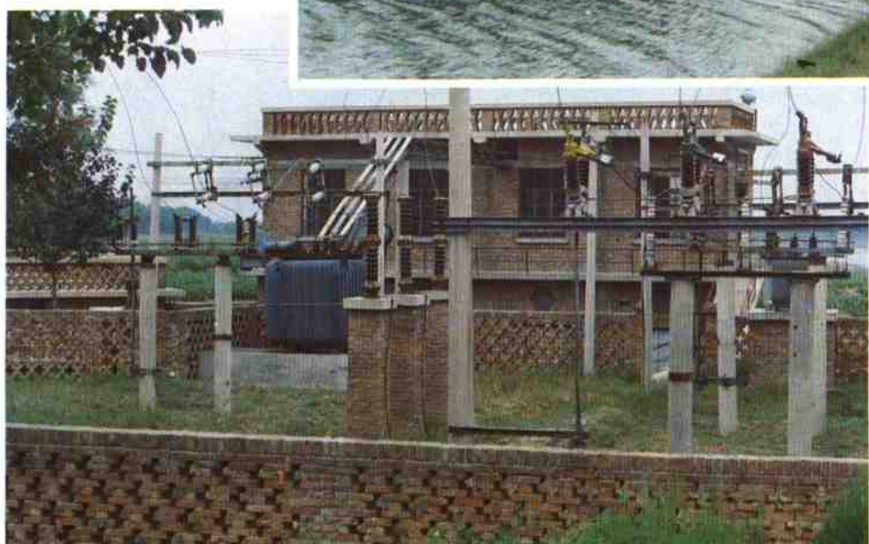
马颊河牟庄排灌站一角
