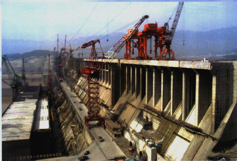
三峡枢纽工程左岸电站坝段及坝后厂房
