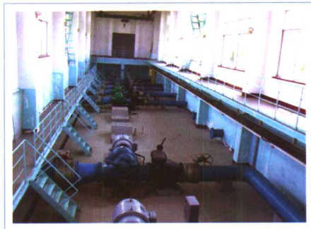
同济水厂泵房
