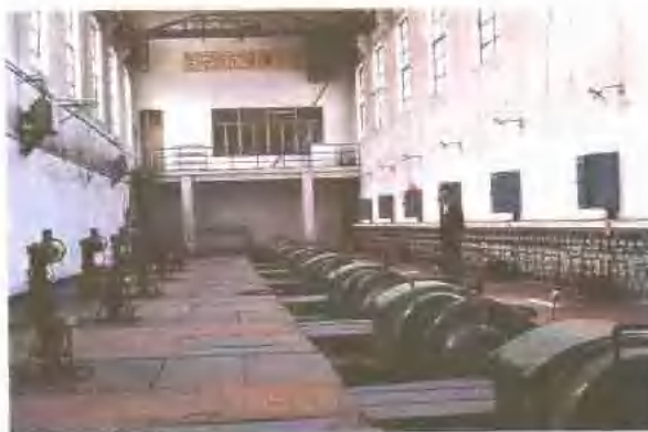
三提配水厂泵房
