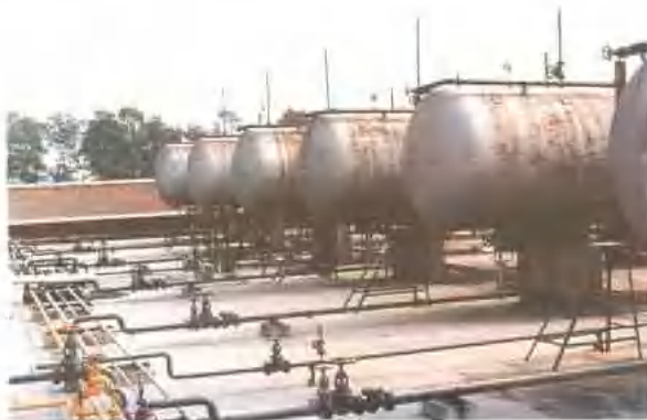
液化气储配站
