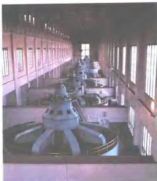
38 丰满电厂内景
