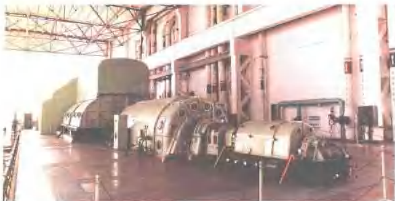
15 望亭电厂内景
