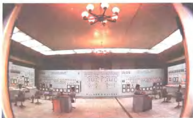
17 陕河电厂主控室
