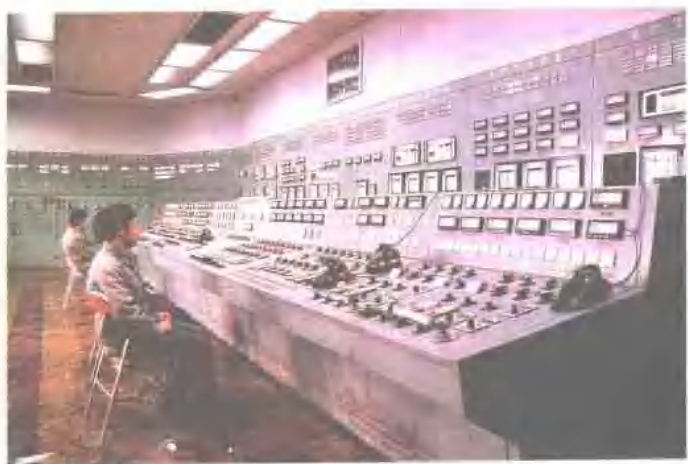
21 清河电厂集控室
