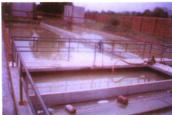
福建福清洪宽福利造纸厂废水处理工程 日处理量 6000\text{m}^3/\text{d}
