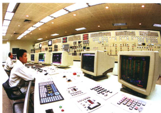
30 万千瓦机组集控室
