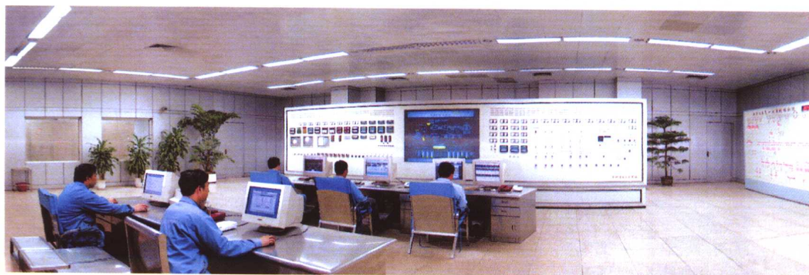
20 万机组单元控制室
