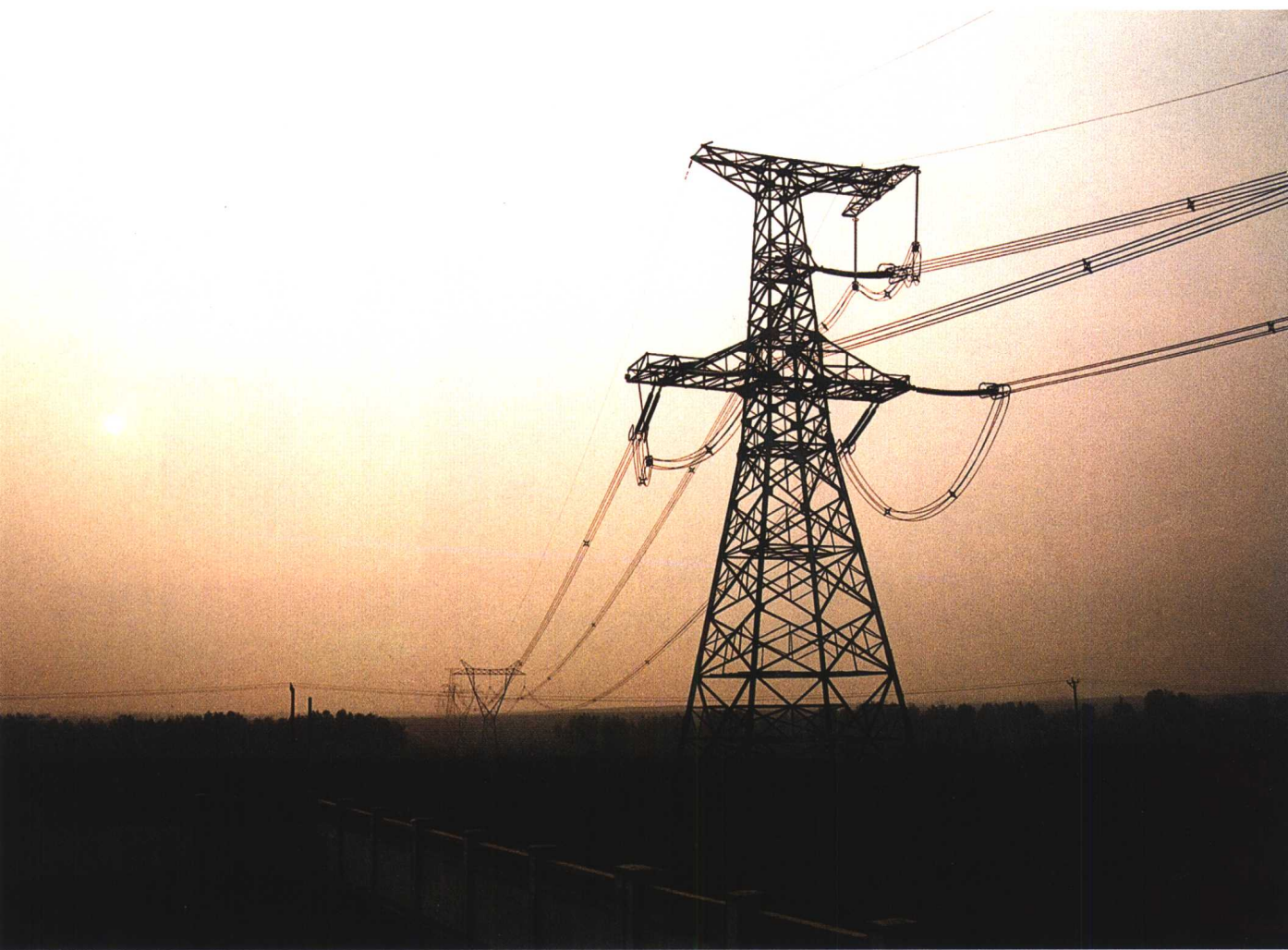
500 千伏邹蒙输电线路
