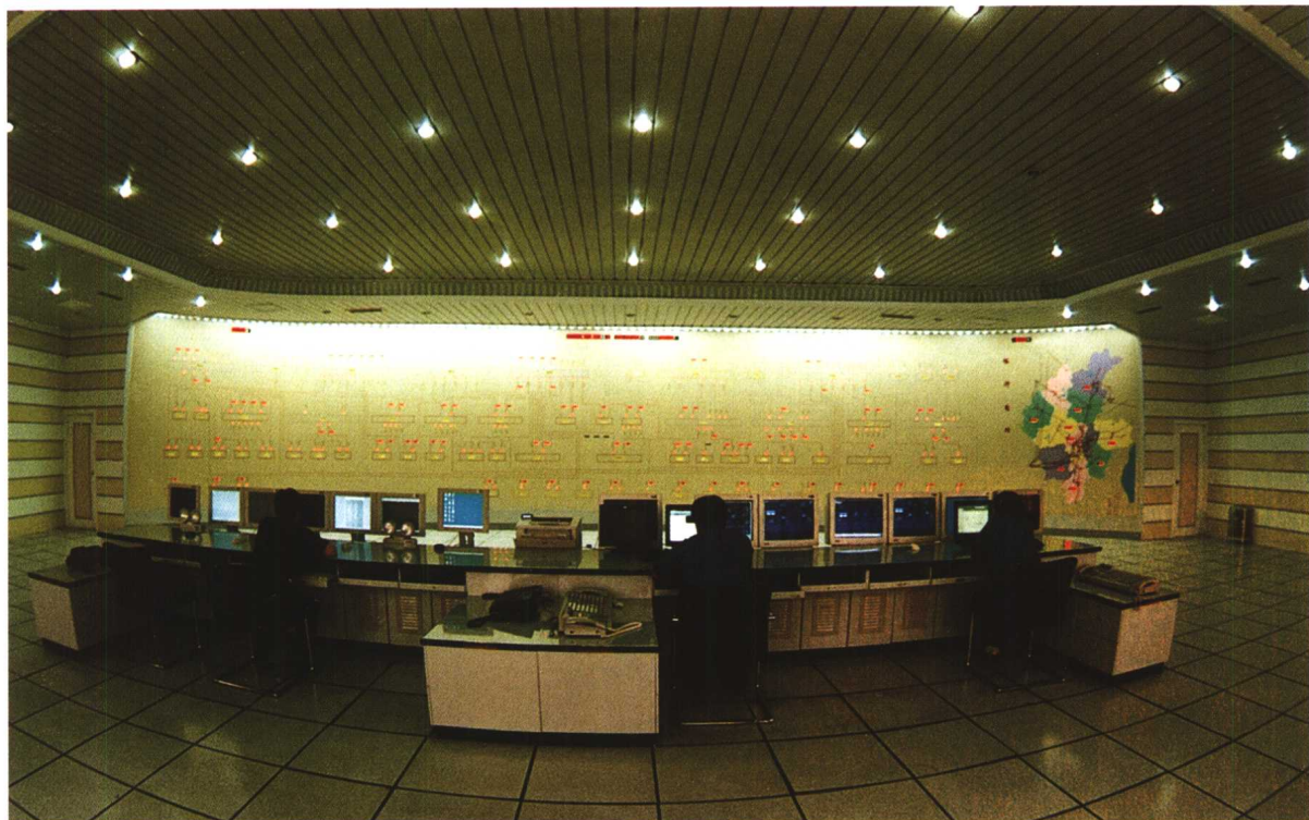
临沂电业局电力调度中心
