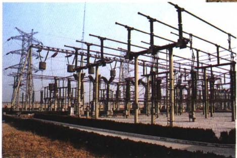
220 千伏沈泉变电站
