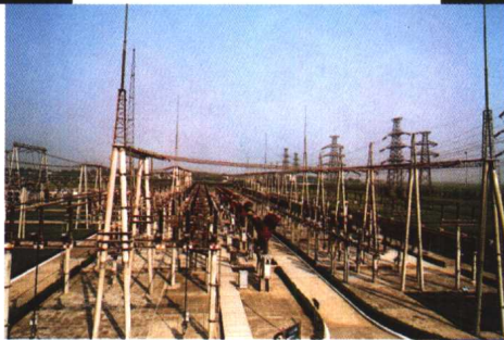
220 千伏相公变电站
