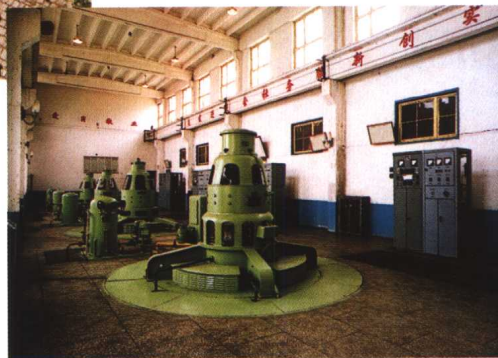
岸堤水电站水轮发电机组
