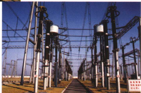
临沂市第一座500千伏变电站——沂蒙变电站
