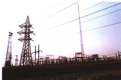
临沂市第一座220千伏变电站——临沂变电站外景
