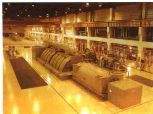
邹县电厂两台 600 兆瓦汽轮发电机组。其中 5 号机组是全国首台达标投产的 600 兆瓦机组，6 号机组是首台免检达标投产的机组
