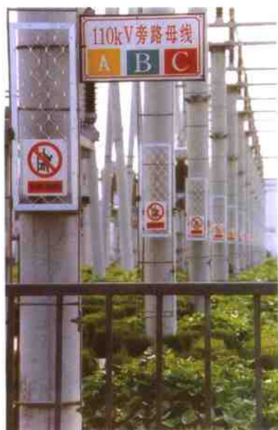
济宁电业局马青变电站实现了“安全设施标准化”
