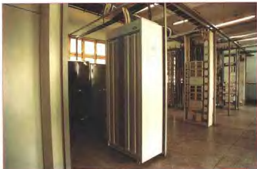
传输机房一角 (1998)
