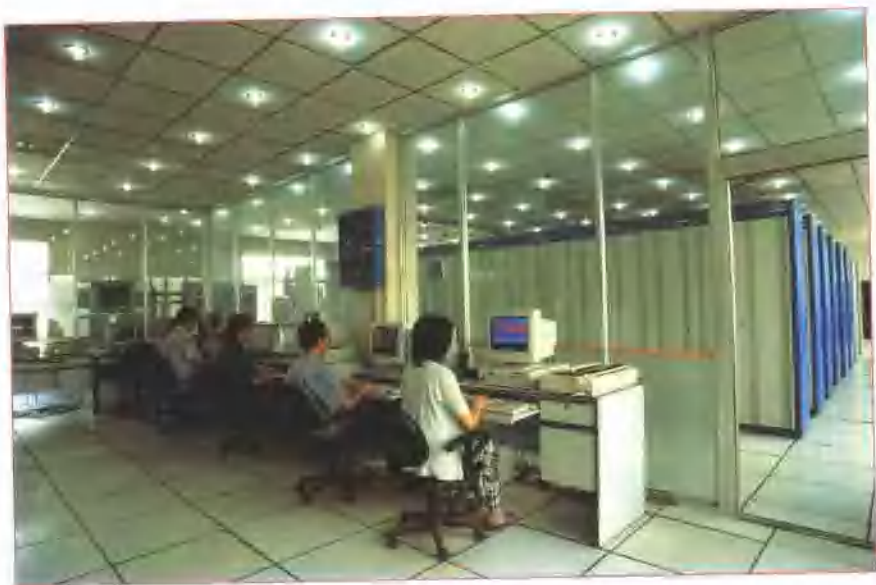
程控电话交换机房 (1998)
