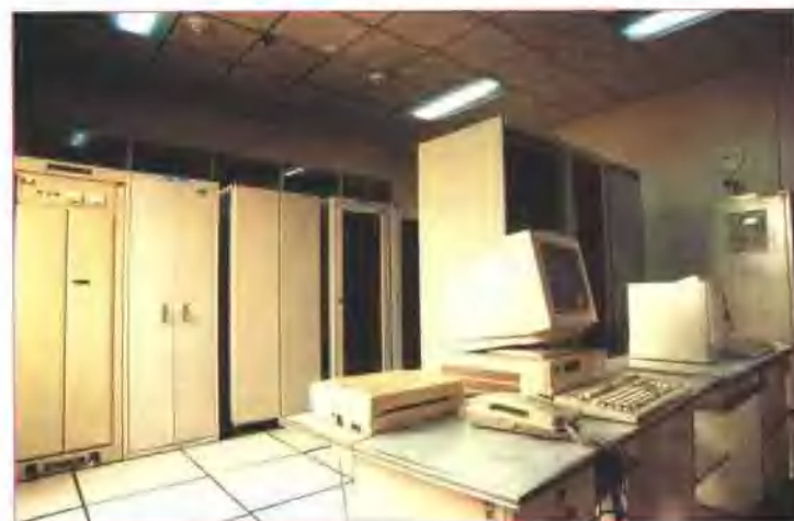
分组交换设备
