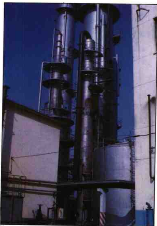
德州化肥厂 11 万吨尿素生产装置
