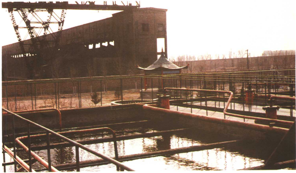
▷包头钢铁厂焦化厂污水处理设施
