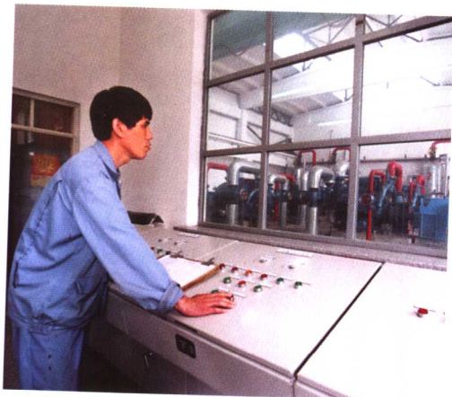
氨压机操作室
