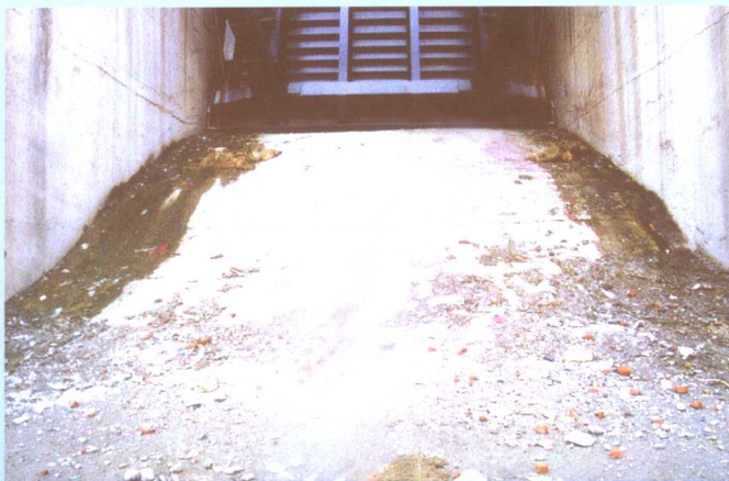
除险加固前的正常溢洪道堰面冲刷情况
