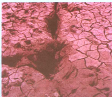
除险加固前的副坝铺盖裂缝
