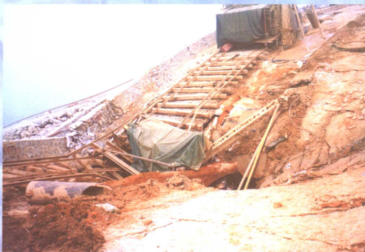
副坝防渗墙施工中的塌坑情况
