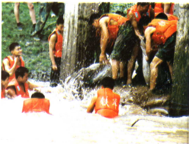
15 8月28日，洪湖市龙口镇高桥闸出现严重窄漏。济南军区某红军团奋战5个多小时，将险情排除 唐金江摄
