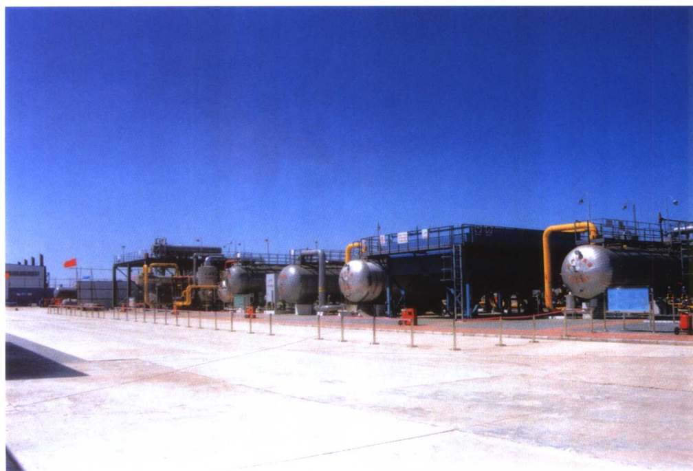
天津大港大张坨地下储气库地面压气设施
