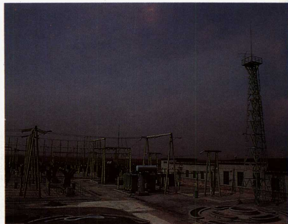
马山子110千伏变电站
