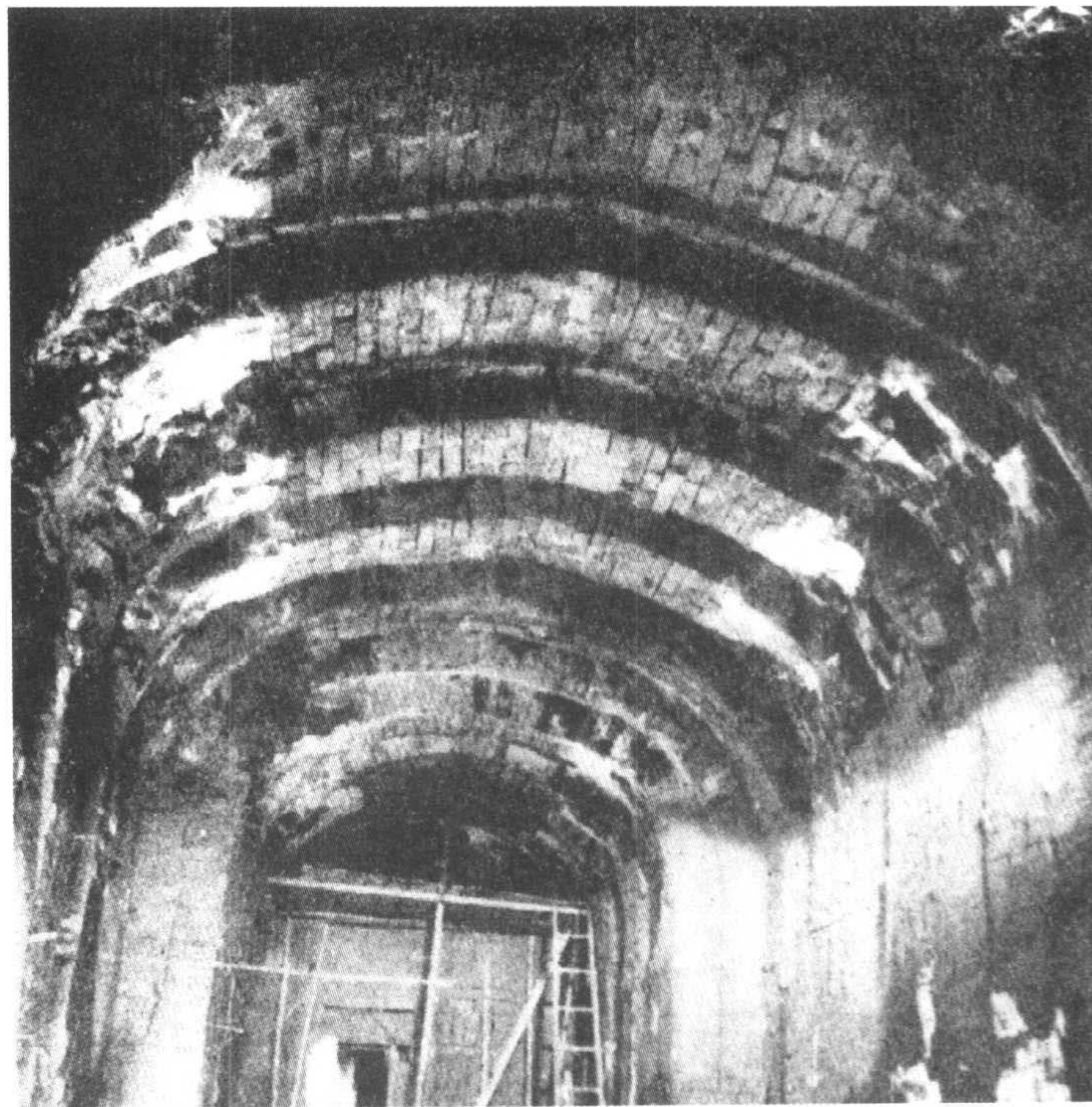
2. 中室與後室券頂破損情況及原來修補之白堊
