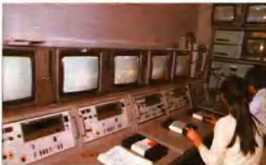
烟台电视台 播出机房（中）
