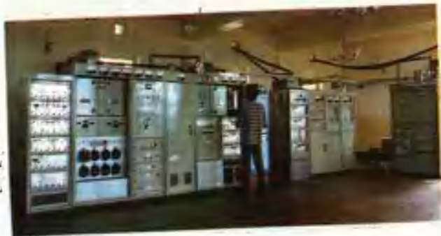
烟台电 视台发射机 房
