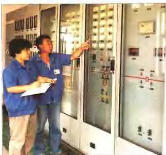
值班人员正在点检设备
