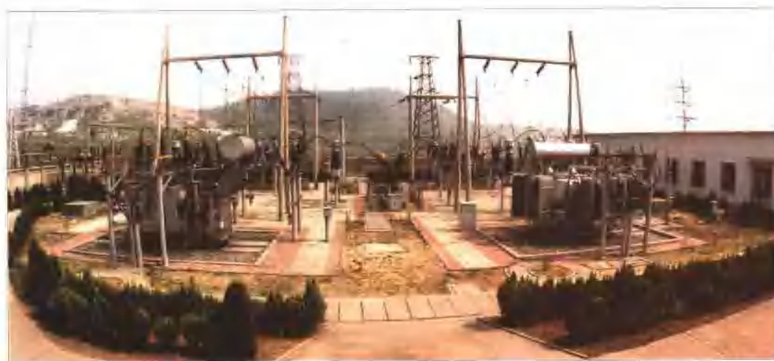
银山变电所新站外景
