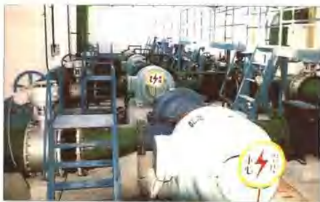
自来水厂泵房
