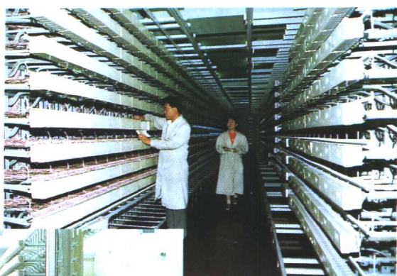
电话交换机机房
