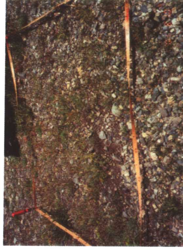
破坏后恢复情况（公路边坡）
