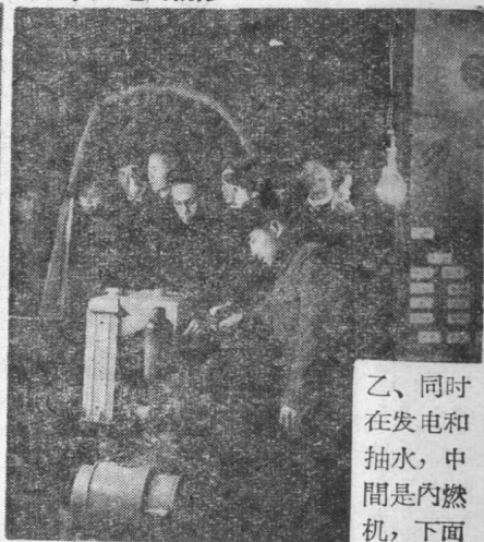
乙、同时在发电和抽水，中间是内燃机，下面是发电机，左方是抽水皮管正在抽水，右方是电灯
