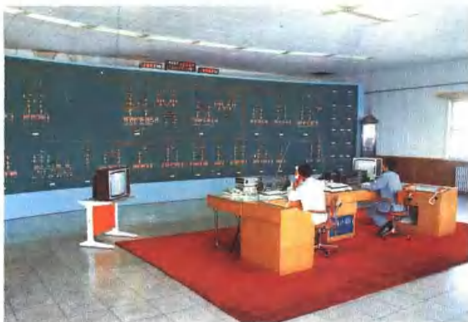
电力局电业调度大厅
