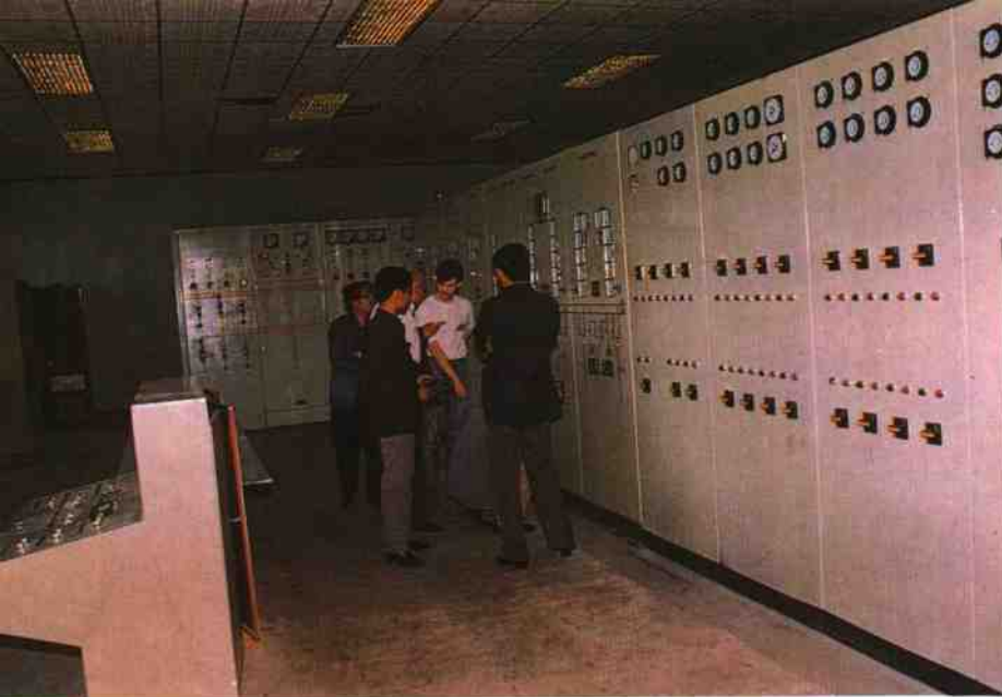
直降机组控制室
