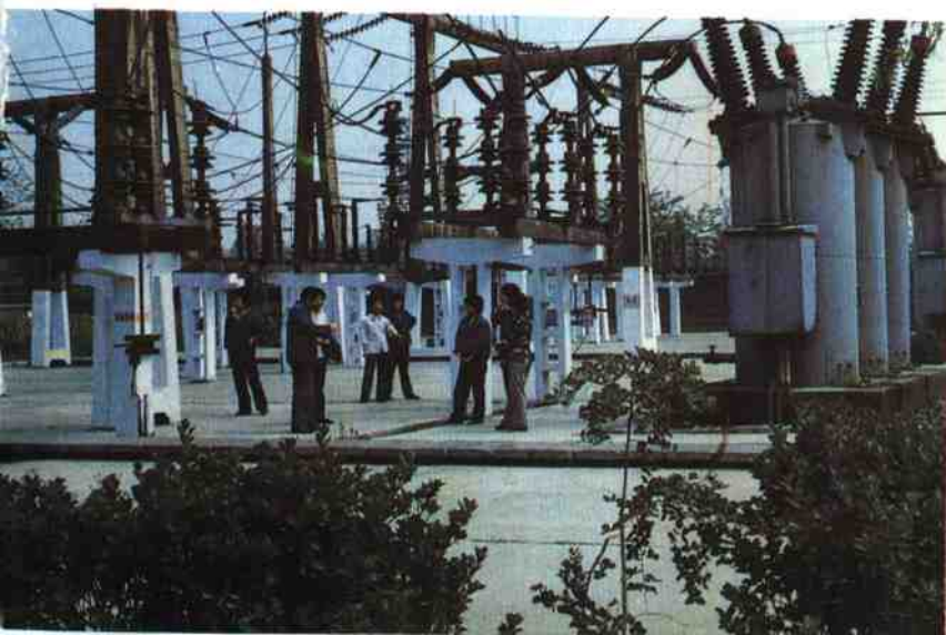
电解铝厂露天变电站
