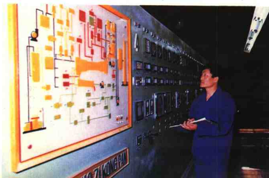
窑前集中控制室
