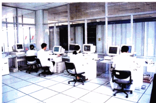
程控交换机房
