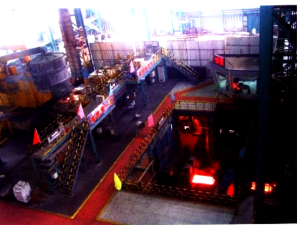
中国唐山钢铁股份有限公司热轧薄板厂 FTSC 薄板坯连铸机全景
