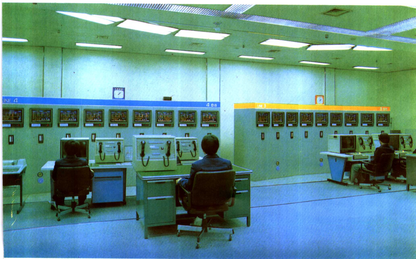
▲ 地铁的电控室 远距离监视、控制地铁各站的灯光、换气、信号、通信等
