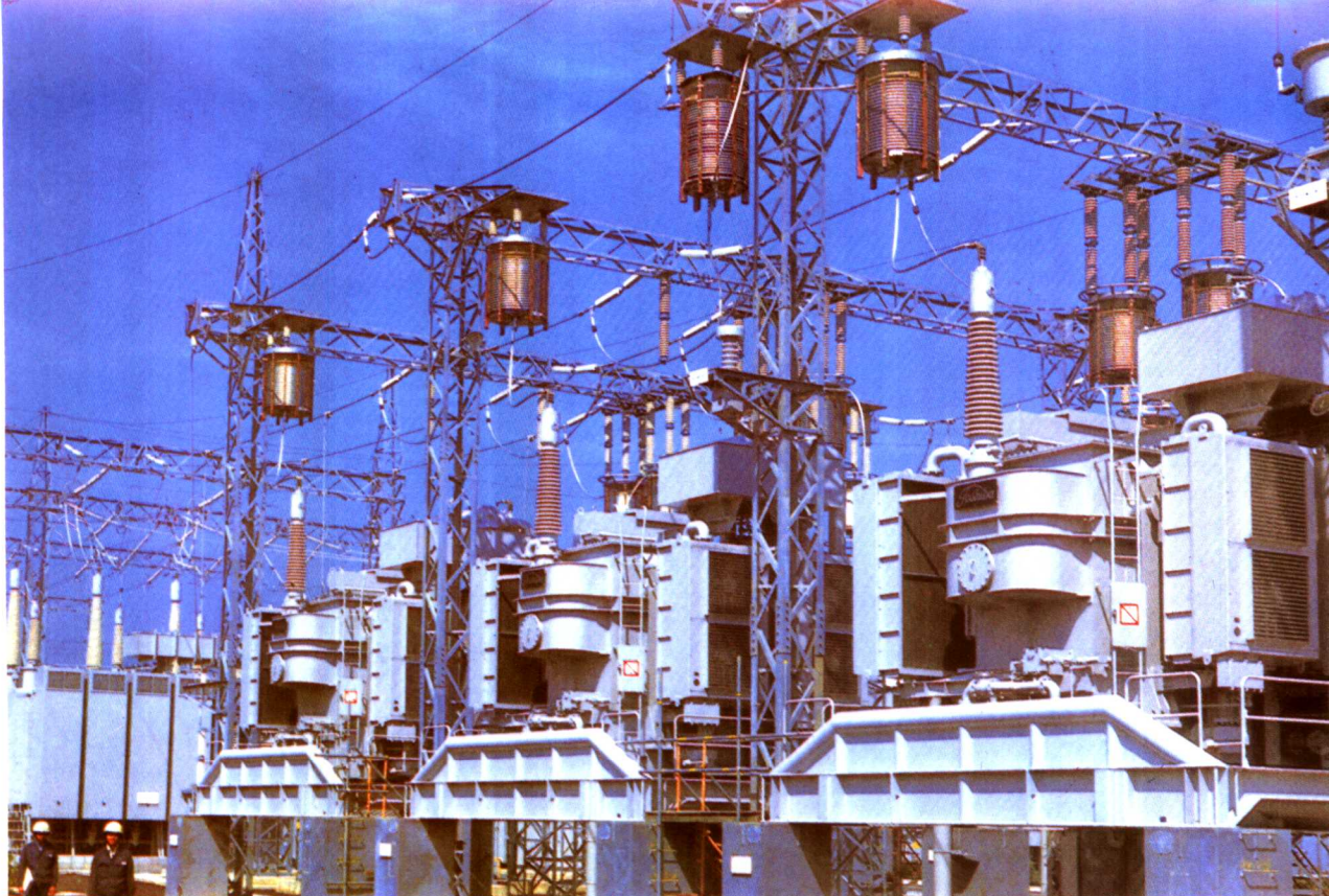
▲ 变电站 用变压器转换电压
