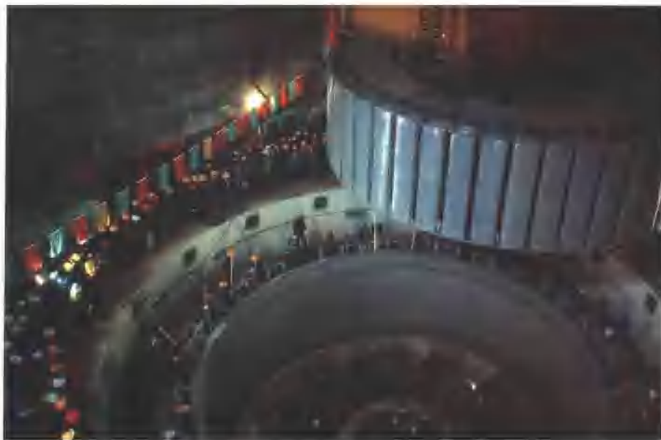
龙羊峡320MW水轮发电机组
