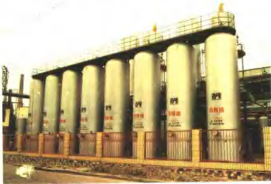
上海吴淞化肥厂1000Nm 3 /h变压吸附提氢装置
