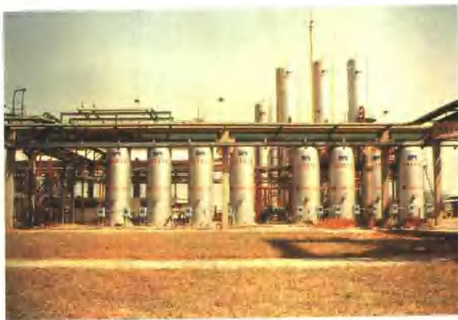
浙江江山化工总厂500Nm 3 /h变压吸附提纯一氧化碳装置
