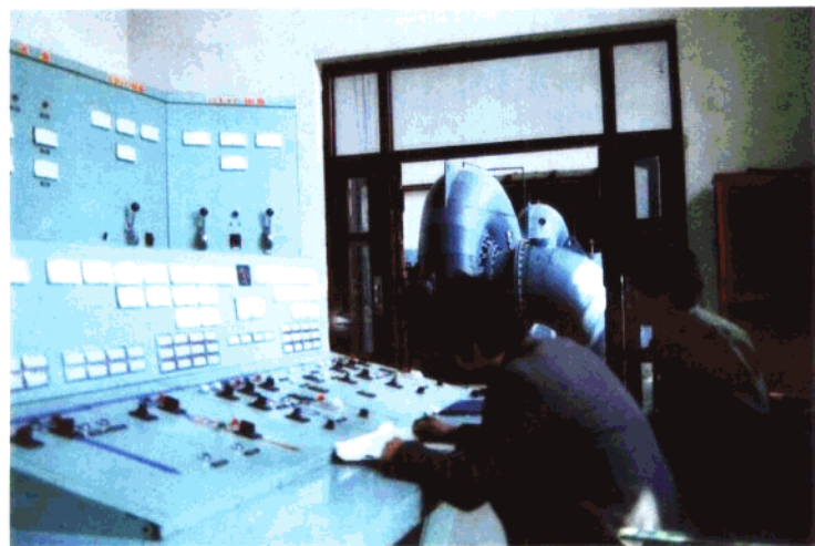
水電站配電室
