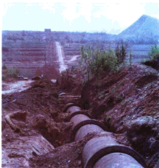
利用礦水倒虹吸管道灌溉
