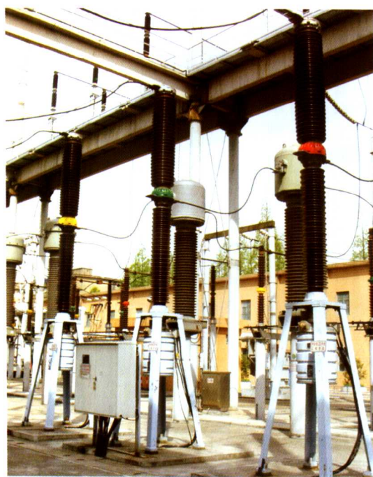
图 3.27 ELFSP4-1 型 220kV 六氟化硫断路器
