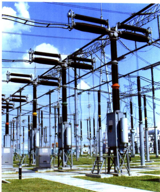
图 3.21 500-SFM-63B 型 500kV 六氟化硫断路器
