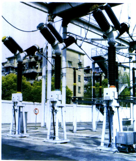
图 3. 30 245-MHME-2Y 型 220kV 六氟化硫断路器
