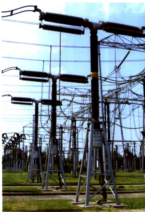
图 4.5 ELFSP7-21 型 500kV 六氟化硫断路器
