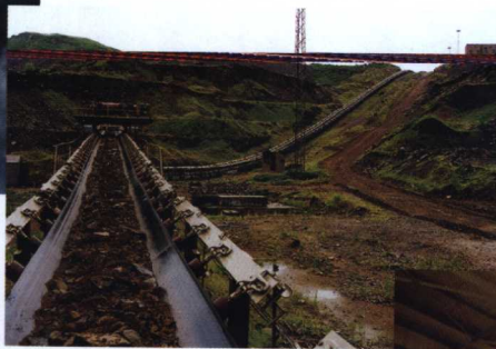
▲ 首钢水厂半连续排岩系统
