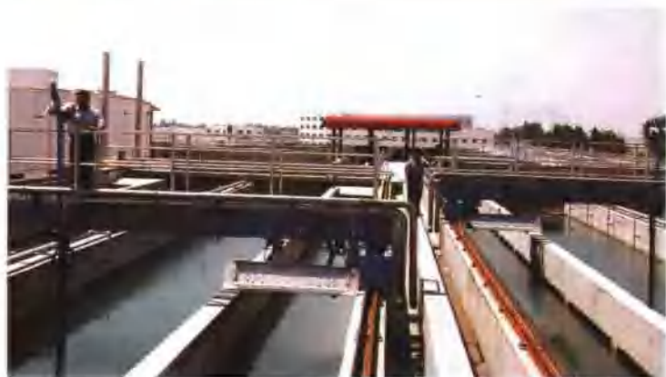
市财政支持城建项目：济宁市污水处理厂
