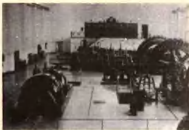
1924年中兴煤矿公司电机厂改名电务处，此为发电机房。
