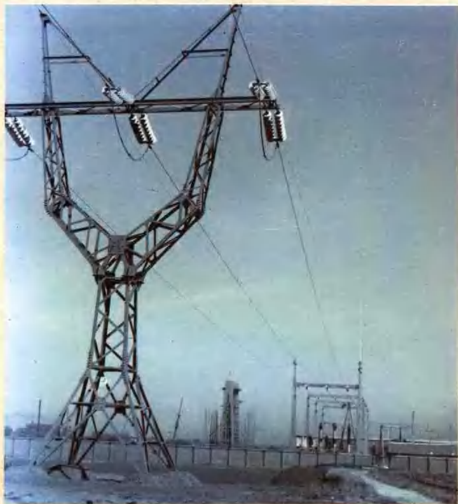
1957年山东省第一个110千伏变电站济南南郊变电站建成投产
