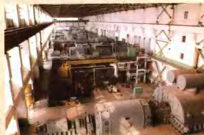
十里泉发电厂5台12.5万千瓦机组
