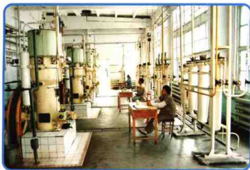
■ 村办企业——青岛乙炔气厂车间一角
