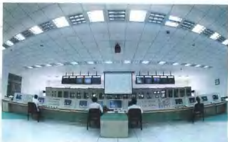
4号高炉主控室内景
