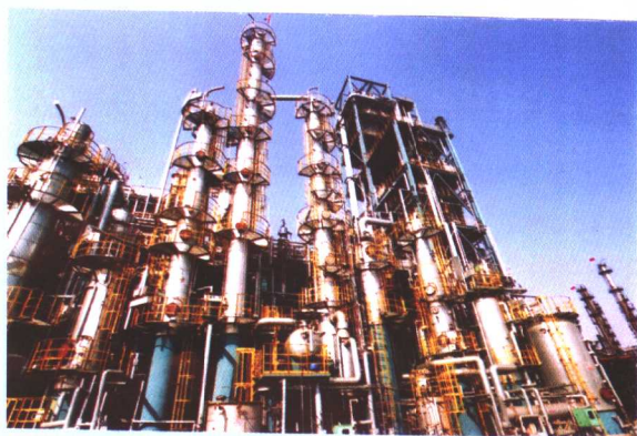
蓝星化工新材料股份有限公司 无锡树脂厂新双酚A装置
