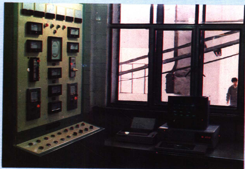
临淄水泥厂应用水泥新技术研究所的成果，使立窑生产水泥实现“闭门操作”和微机控制。
