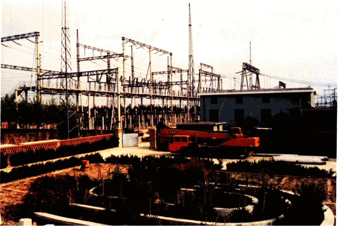
220 千伏临邑变电站
