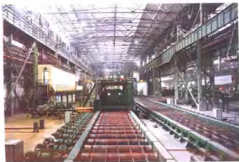
2800轧机改造配套设 施11 辊钢板矫直机
