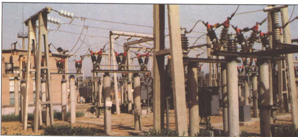
明水十一萬伏變電站
