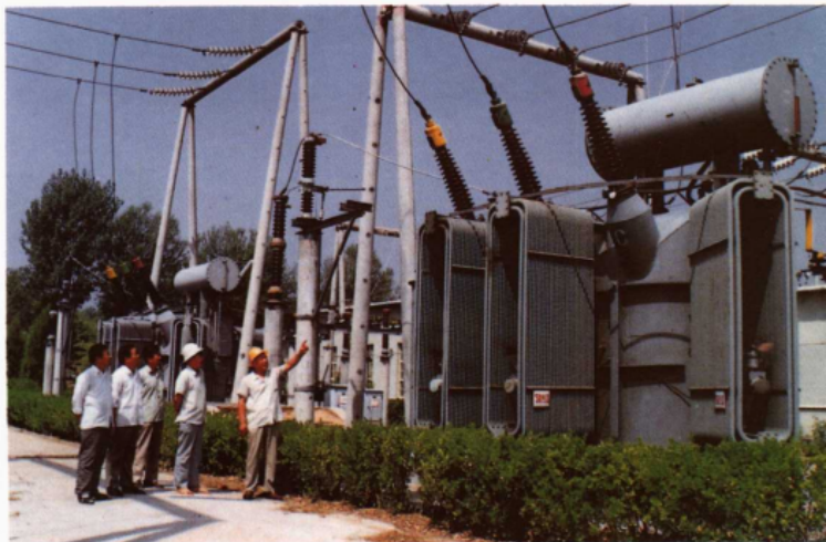
十一万伏变电站
