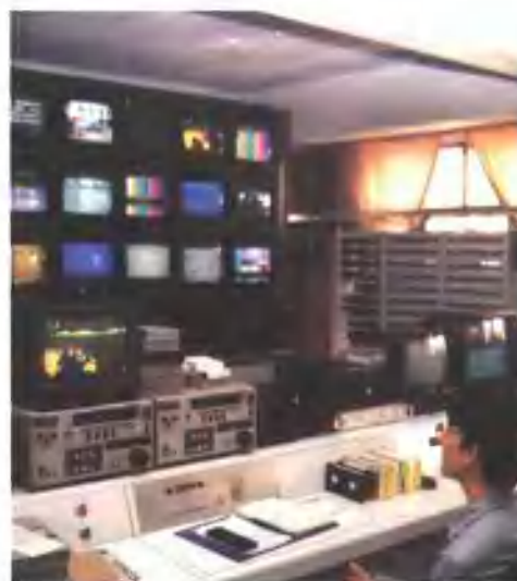
有线电视播控台
