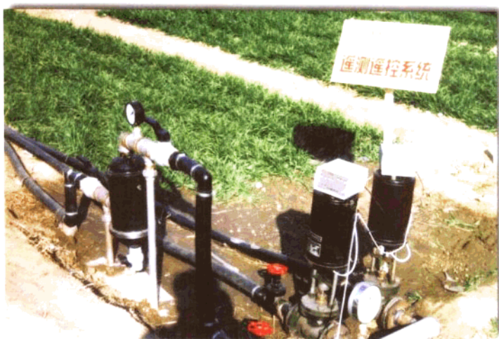
灌溉系统首部设施及控制系统
