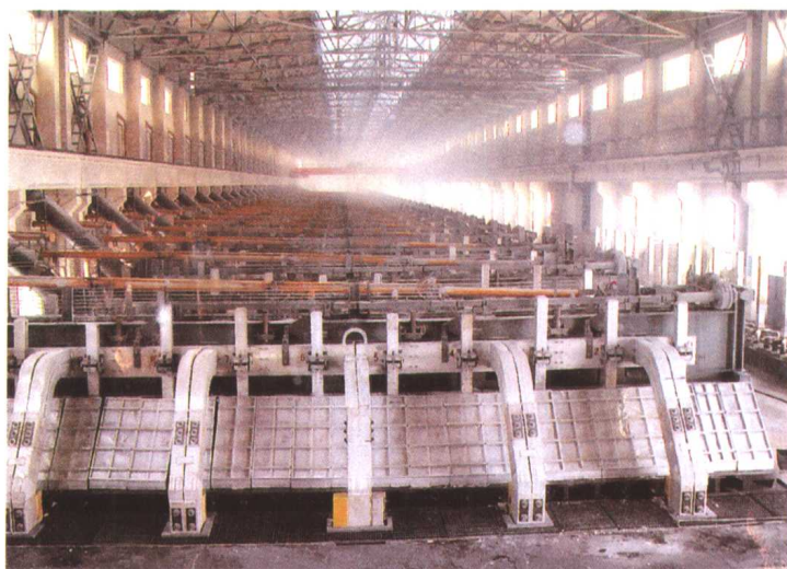
彩图9 龙泉伊川铝厂 300kA 大型预焙槽系列
