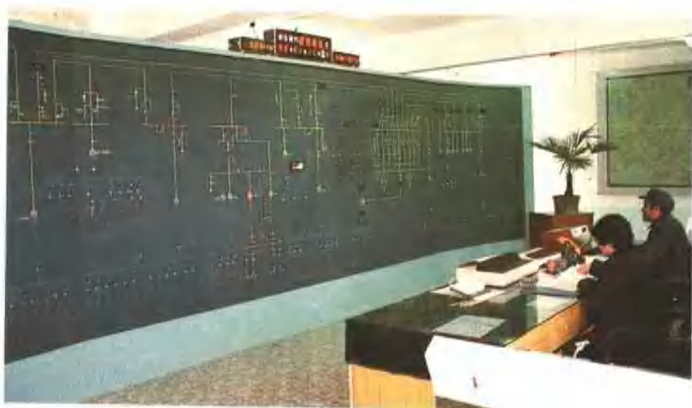
⑨电力调度值班室
