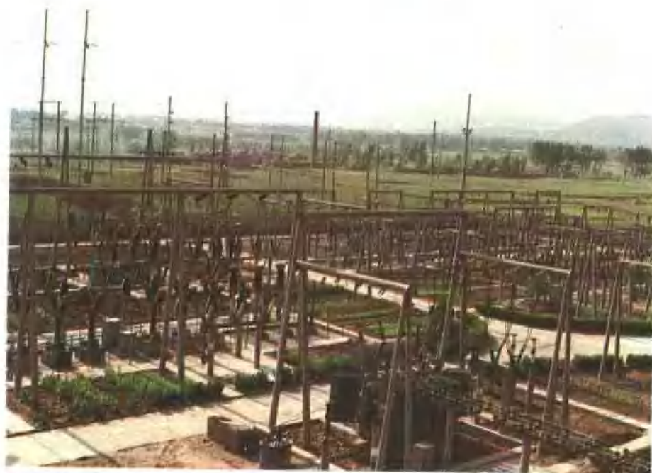
⑩界湖110千伏变电站
