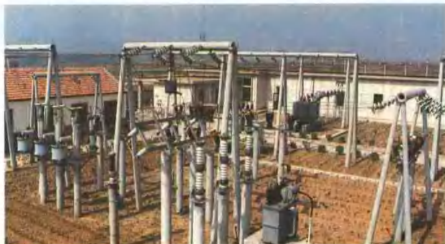
⑪里庄35千伏变电站
