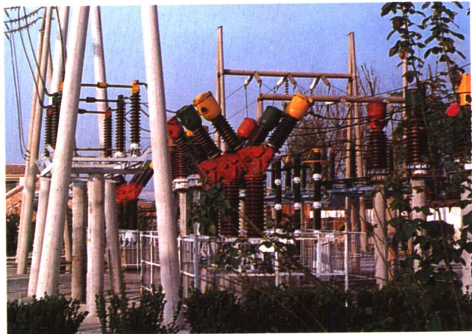
单县供电局 110 千伏变电所
