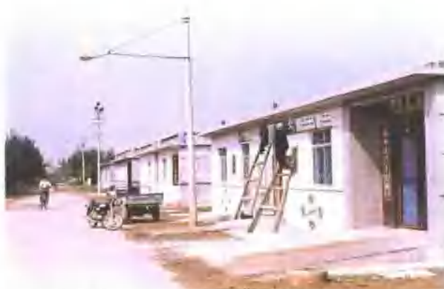
农村低压电网改造
