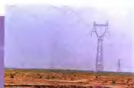
220KV输电线路走廊
