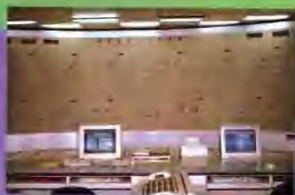
电网调度中心
