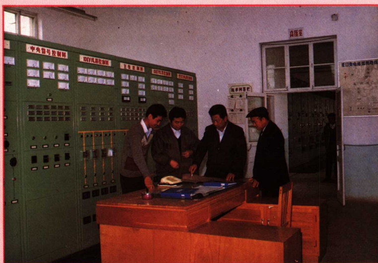
夏口镇党委书记刘延治(右二)在镇变电所配电室
