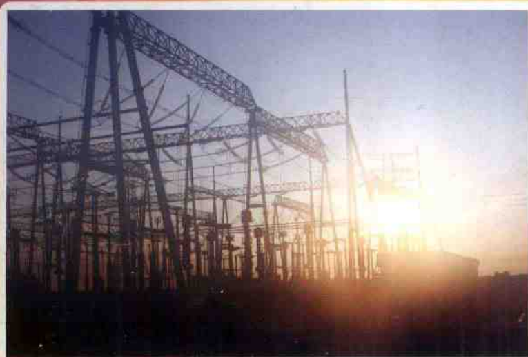
晨曦中的500千伏港城变电站
